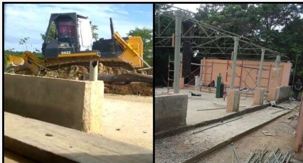
Fuente: “La Seguridad del Estado desmantela una iglesia en Santiago de Cuba”, 14 y medio
